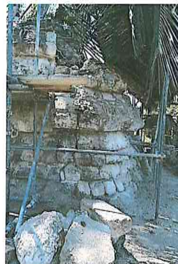
Trabajos de restauración en relieves, vista desde la esquina noroeste, avances en el proceso de consolidación de sillares
